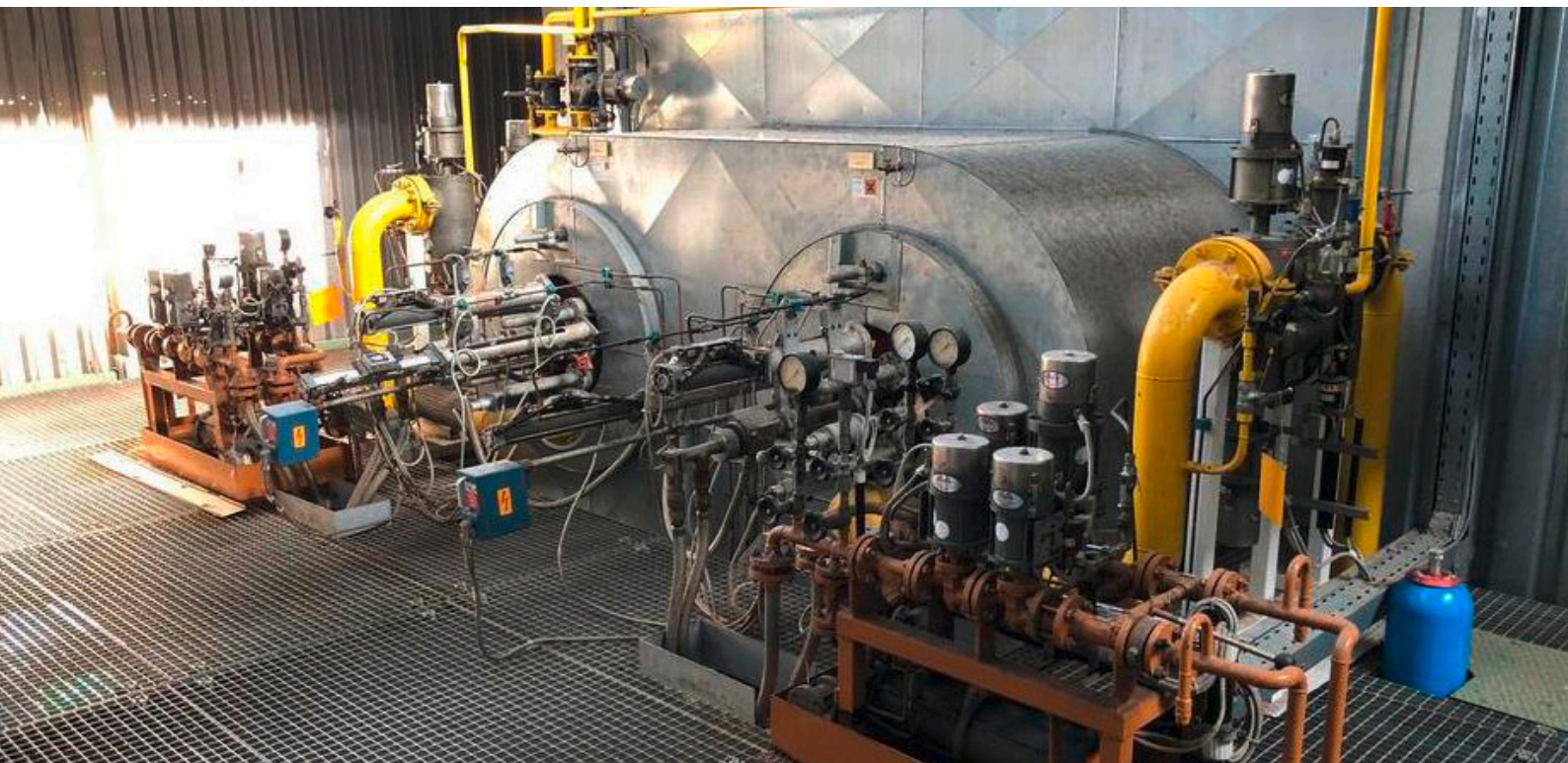
Abb. 28: Heizkessel des Heizkraftwerkes am Standort Wörth
